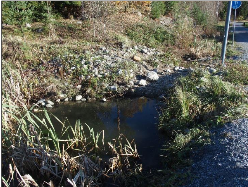
Kuva 9. Esimerkki jalankulku- ja pyöräilyväylän reunaojasta, johon on toteutettu pieni allasmainen levitys ja pohjapato. Kiintoaineksen poistamista työmaavesistä voidaan edistää vastaavalla rakenteella. Pohjapadon materiaalina tulisi käyttää esimerkiksi salaajasoraa ja louhetta. © Destia Oy 2024.
