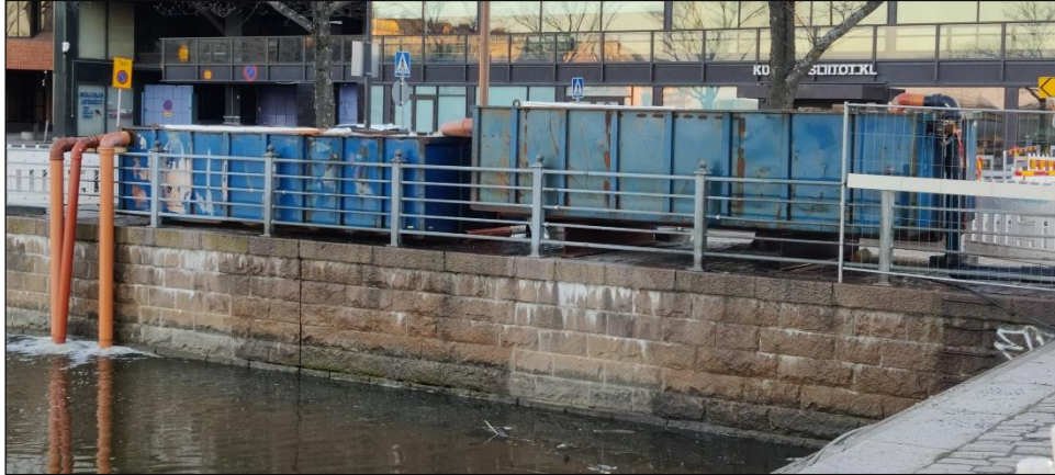
Kuva 11. Hulevesien työmaan aikaiseen viivyttämiseen ja suodattamiseen käytettävä laskeutuskontti. Vedet tulisi johtaa mahdollisuuksien mukaan kasvillisuuspainanteeseen. Purkuvesien suodattamisen parantamiseksi purkupäähän (kasvillisuuspainanteeseen) voidaan asentaa esimerkiksi tarvittaessa vaihdettava suodatinkangas tai väliaikainen suotopato. © Destia 2024.
