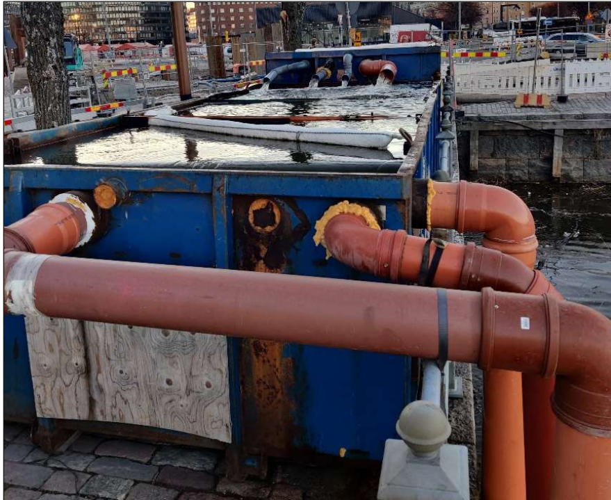
Kuva 9. Hulevesien työmaan aikaiseen viivyttämiseen ja suodattamiseen käytettävä vesitiivis laskeutuskontti. Konttiin pumpataan vedet työmaan kaivannosta. Konttiin on toteutettu väliseiniä hidastamaan veden virtausta ja edistämään kiintoaineksen laskeutumista. Järjestelmässä on kaksi konttia peräkkäin. Jälkimmäiseen konttiin ohjataan vedet ensimmäisen kontin pinnalta. © Destia, 2024.
