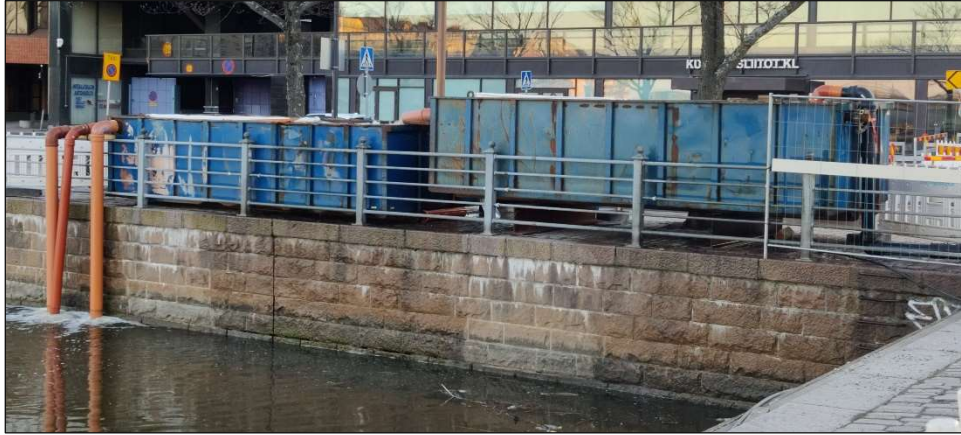
Kuva 10. Hulevesien työmaan aikaiseen viivyttämiseen ja suodattamiseen käytettävä laskeutuskontti. Vedet tulisi johtaa mahdollisuuksien mukaan kasvillisuuspainanteeseen. Purkuvesien suodattamisen parantamiseksi purkupäähän (kasvillisuuspainanteeseen) voidaan asentaa esimerkiksi tarvittaessa vaihdettava suodatinkangas tai väliaikainen suotopato. © Destia, 2024.
