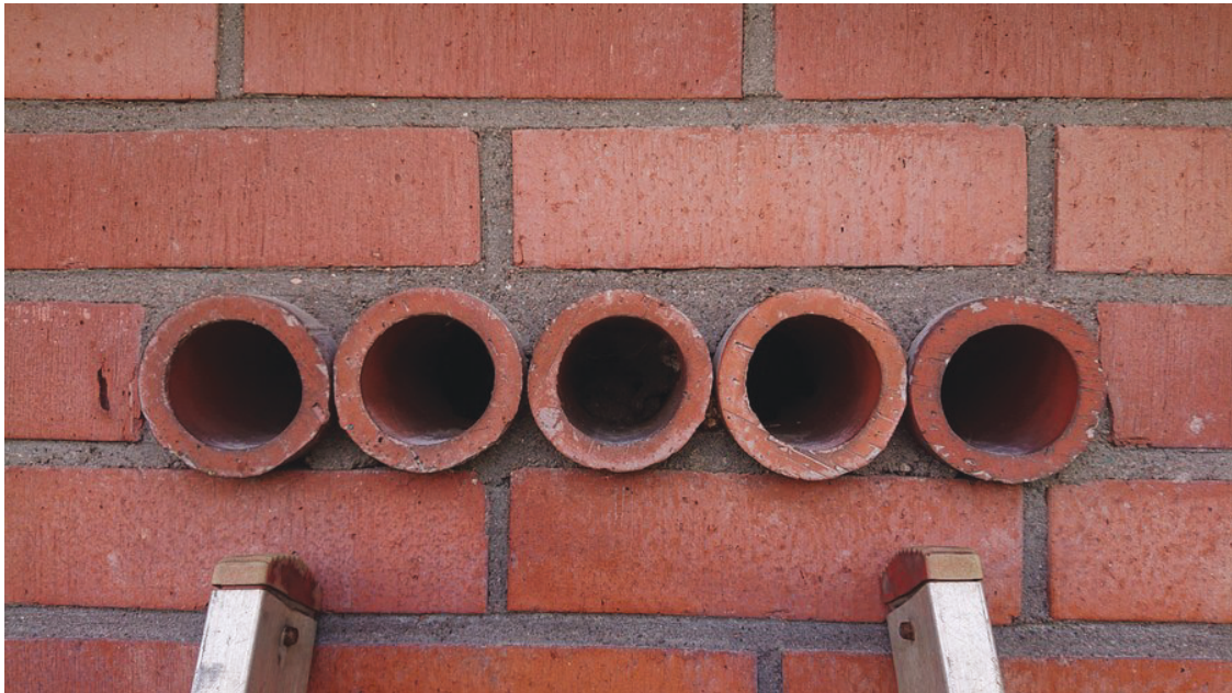
Kuva 5. Muuntajan yläosassa oli tiiliset tuuletusaukot.
